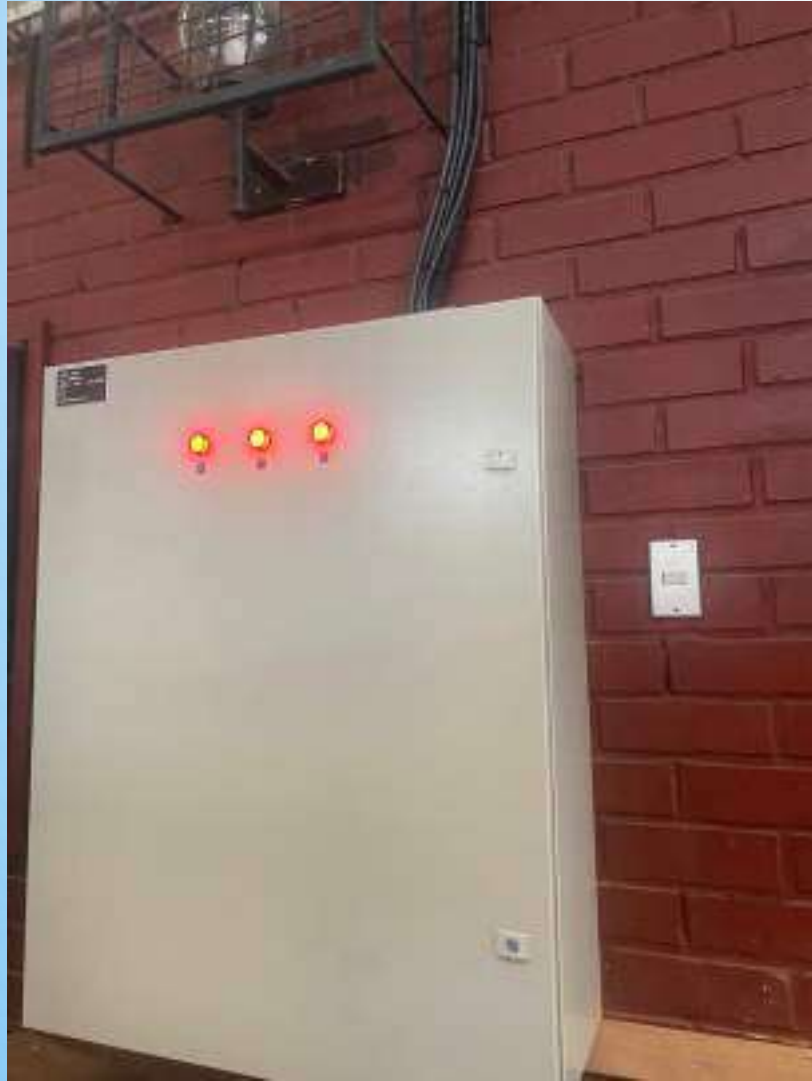
Nuevo Tablero Eléctrico
